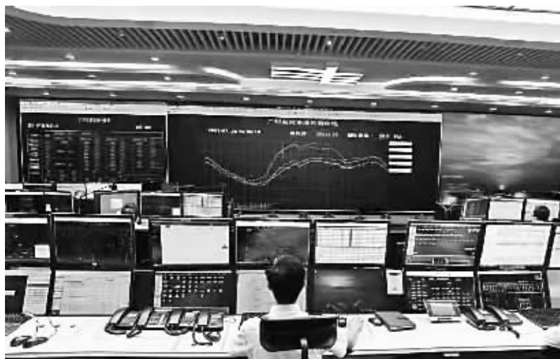
7月26日13时59分，广州电网用电负荷历史首次突破2000万千瓦。
