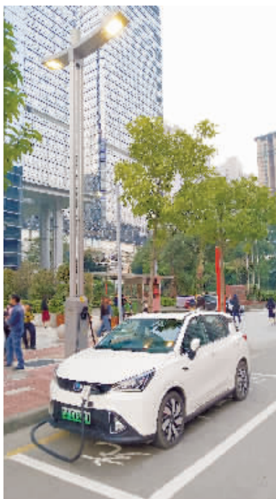
在广州天河南二路,一辆汽车正在利用智慧灯杆充电。
